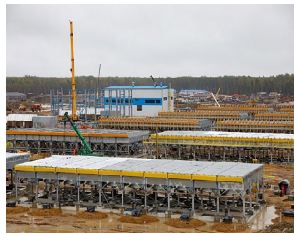
Установка подготовки газа к транспорту КС «Славянская»
