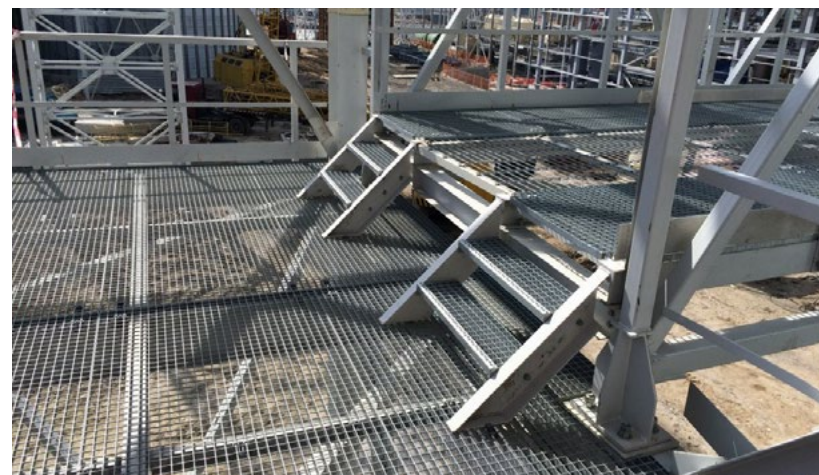
Пожарные лестницы, мостки, переходы
